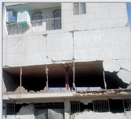
شکل ۳: انهدام خارج از صفحه دیوارهای بنایی
