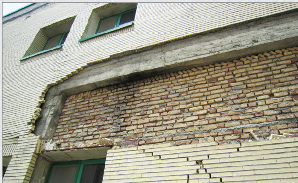
شکل ۱۴: ریزش قطعات آجر نما
