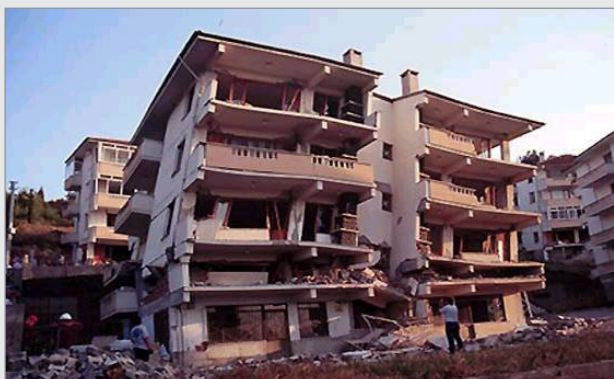
شکل ۱۱: تخریب در اثر حرکت پیچشی ساختمان
