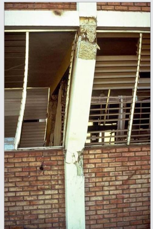
شکل ۹: شکست ترد برشی در ستون بتنی
